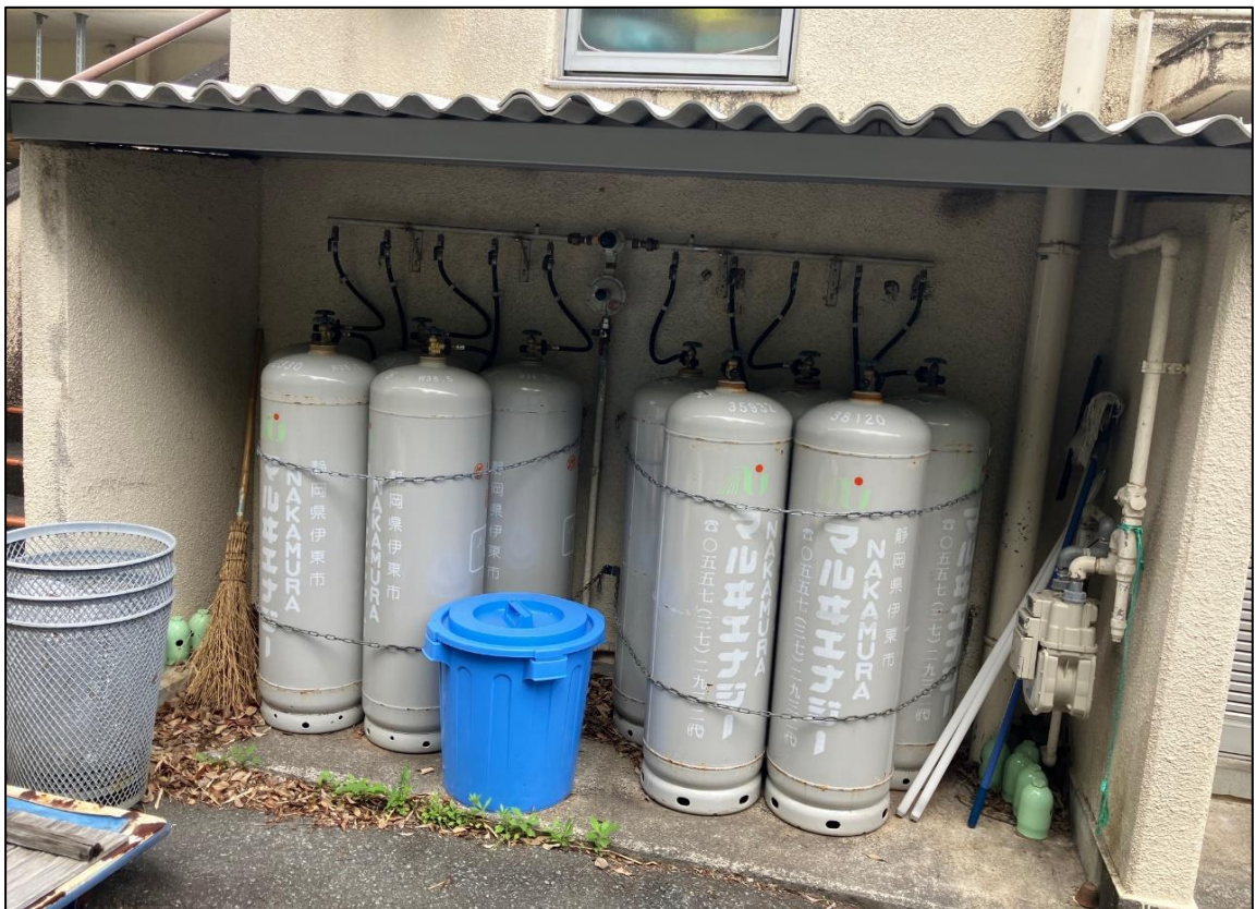
既設ガスボンベ 10本
