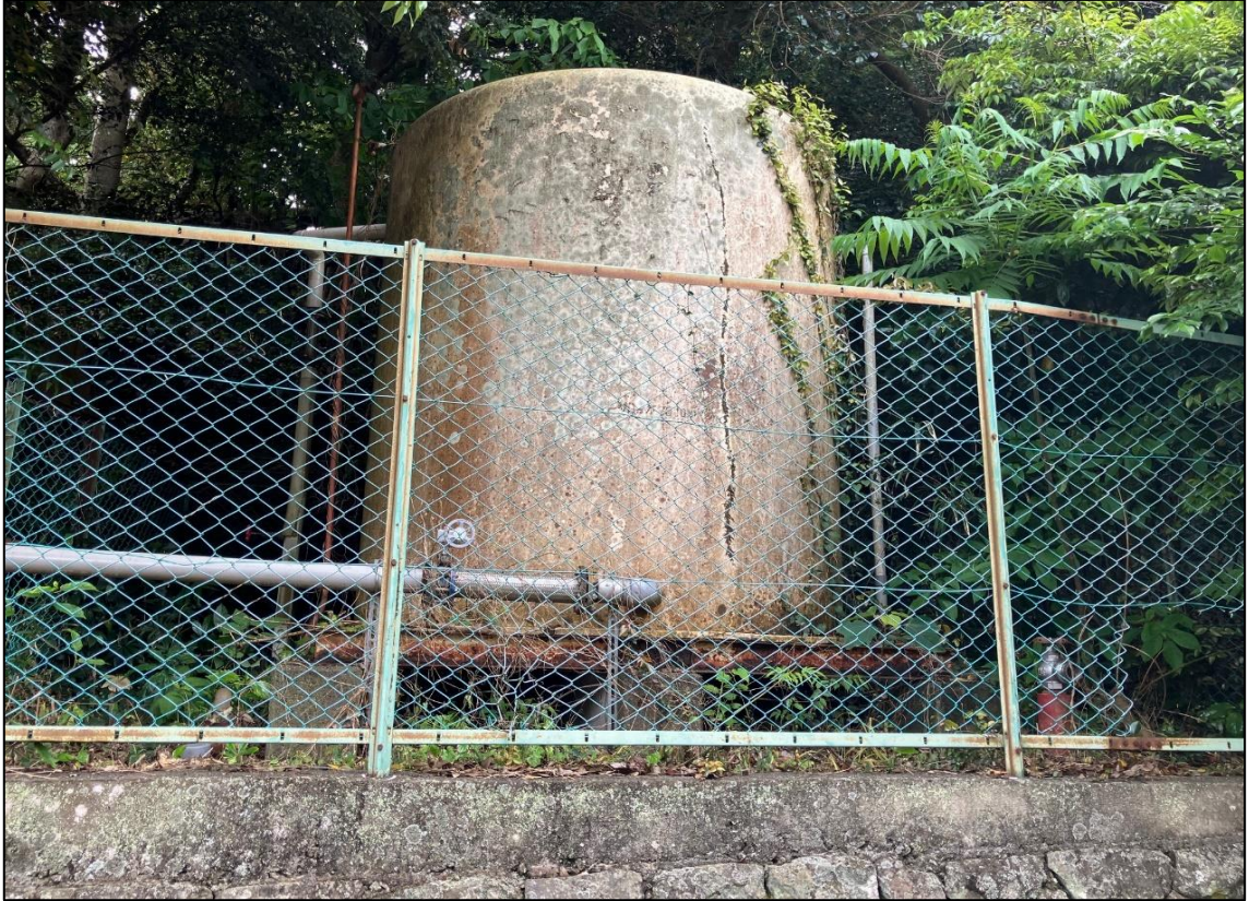
既設屋内消火栓用10 t 水槽
