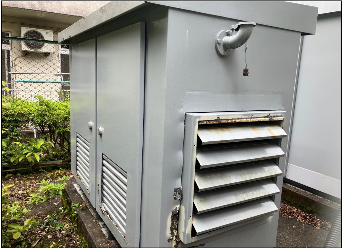
既設発電機 デンヨー製 (昭和53年製造)
